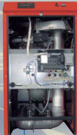
Vista interna, quadro elettrico
