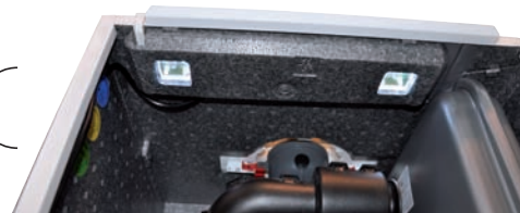
Détail de l'éclairage interne de la chaudière
