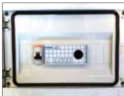
Telecontrollo installato nel quadro elettrico PVC in prossimità regolazione elettronica modelli CND-GT3 – GT3 PLUS – 3GF
