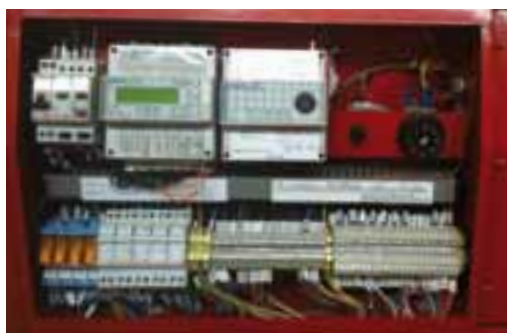
Telecontrollo installato nella regolazione elettronica di caldaia (MODEM PMX – MDL – BOX – CTP)
