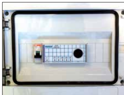
Telecontrollo installato nel quadro elettrico PVC in prossimità regolazione elettronica (per caldaie SERIE CND – GT3 PLUS – 3GF)
