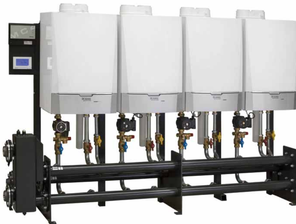
Con 4 caldaie Quinta Pro installate in linea senza isolamento
