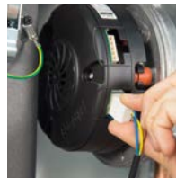
Disconnessione elettrica ventilatore
