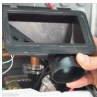
Ispezione raccolta condensa
