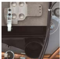
Sblocco raccolta condensa
