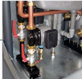
Pompe e saracinesche d'intercettazione idraulica
