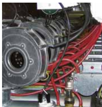
VISTA D'INSIEME VENTILATORI E VALVOLE GAS
