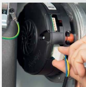
Disconnessione elettrica ventilatore
