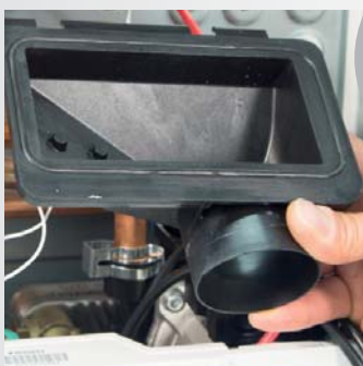
Ispezione raccolta condensa
