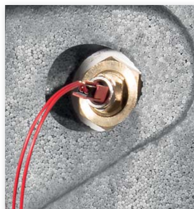
Sonda sanitaria nel bollitore e isolamento in polistirolo autoestinguente
