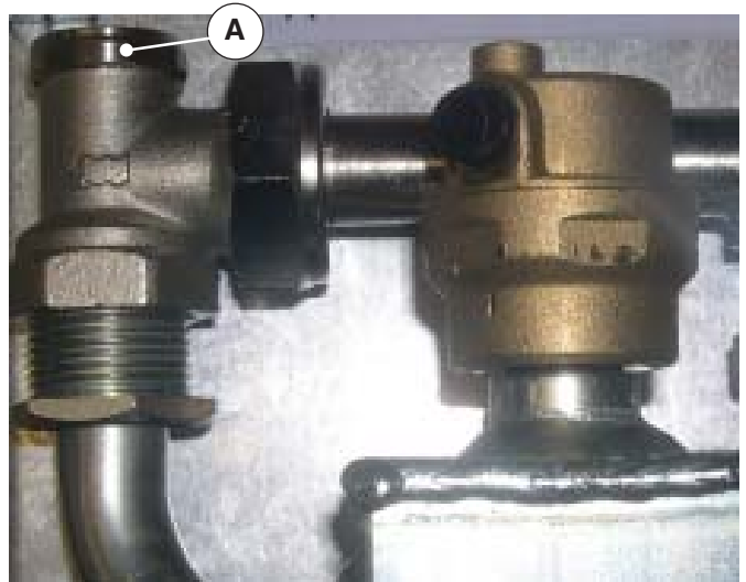
Detentore circuito primario caldaia
