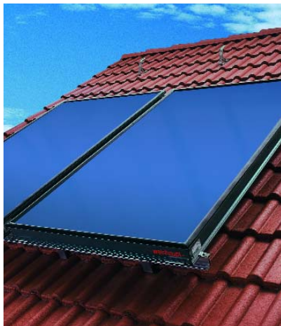
Collettore sopra tetto
