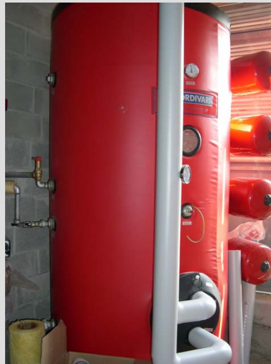
accumulo acqua calda (CORDIVARI) con vasi di espansione in serie
