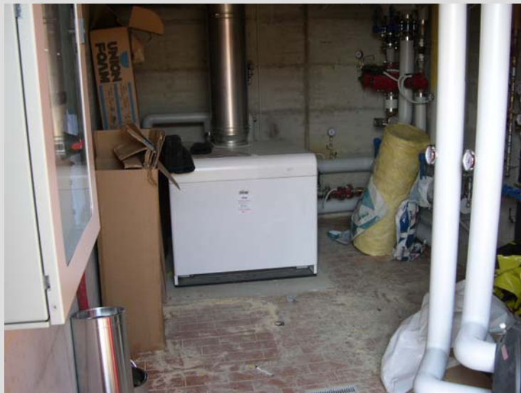
caldaia FERROLI 100kW
